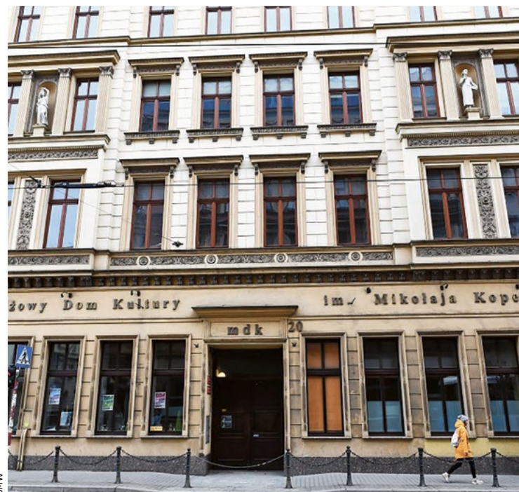
Kamienica wybudowana w 1858 r. wymaga poprawy stanu technicznego
